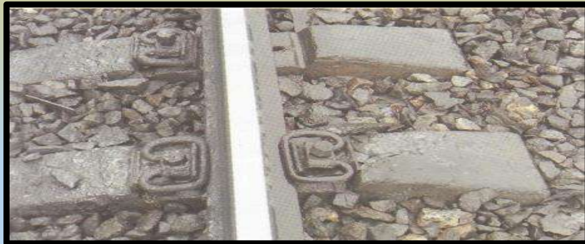
Скрепление ЖБР-65Ш со сломанным шурупом на полевой стороне и запавшей клеммой с внутренней стороны колеи. Для восстановления узла требуется удаление оставшегося в отверстии шпалы стержня шурупа
