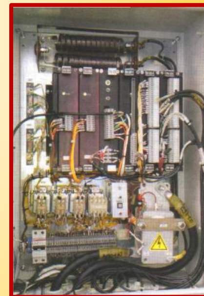
Шкаф управления САЗДТ
