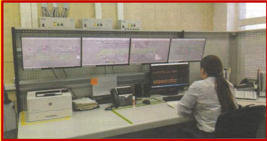
Рабочее место дежурного по станции
